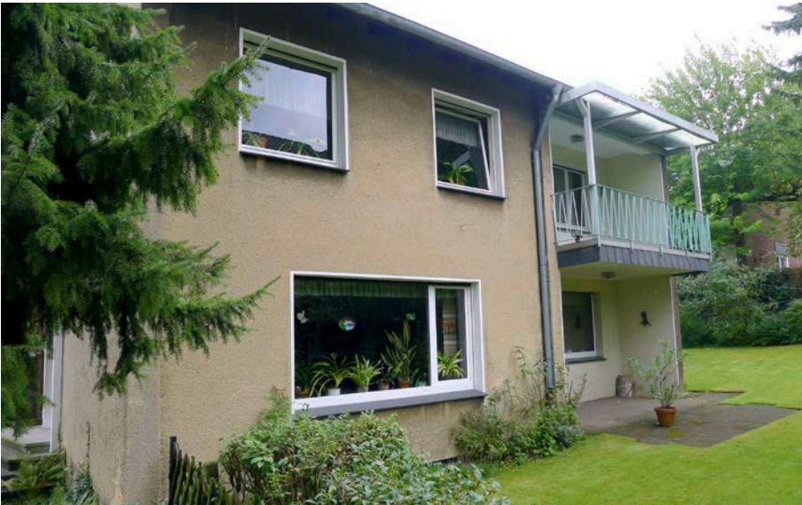
(2) Auch zur Vermeidung von Wärmebrücken musste dieser Balkonbau aus Beton durch ein Modell aus Holz ersetzt werden.
